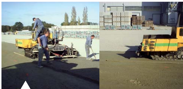
Utiliser un finisseur pour la pose de la gravelette section 2/4 directement sur le fond de forme
