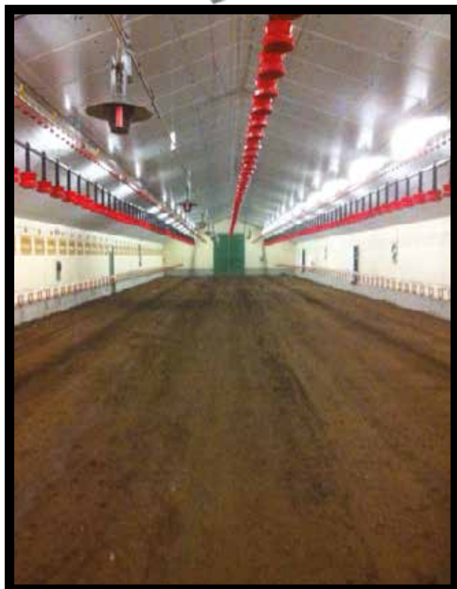
Exemples de réalisation en longrines isolantes dans un poulailler.
